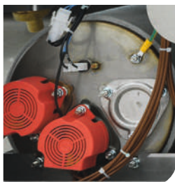
Surchauffeur pour alimentation en eau froide
